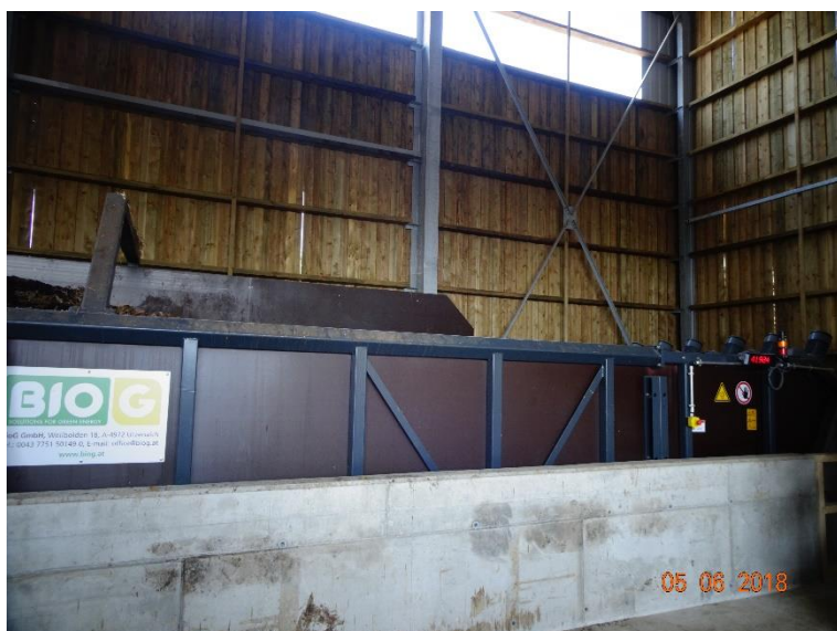
Photo 2 : Benne – trémie d'incorporation BioGmbH
