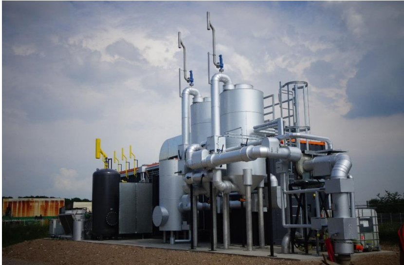
Méthaniseur des deux Vallées : système d'épuration du biogaz
